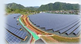
愛川太陽光発電所
