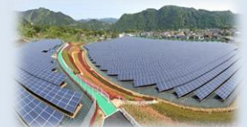
愛川太陽光発電所
